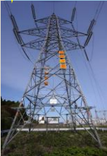
187kV JR吉岡線 鉄塔
